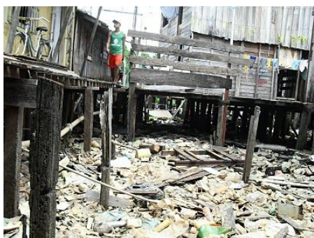
Figura 6 – Pontes deterioradas e esgoto a céu aberto na Vila da Barca.
